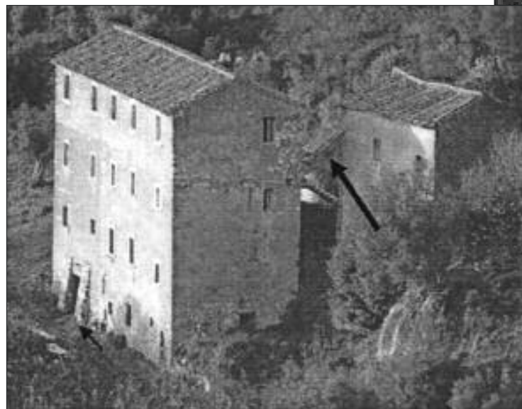
Fig. 7 - ARCHETTO ANTISISMICO SOVRASTATO DA UN PICCOLO SPERONE IN MURATURA CHE SORREGGE I DUE FABBRICATI SECENTESCHI. NEL FABBRICATO GRANDE, SI NOTANO IN BASSO A DESTRA DUE SPERONI
